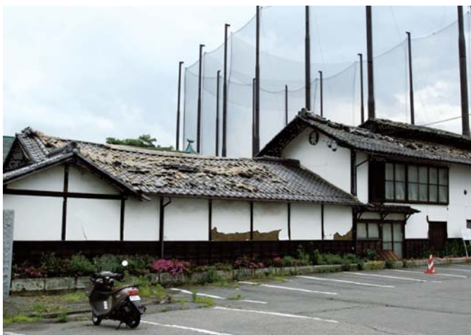
写真3 松本市で発生した地震による被害
