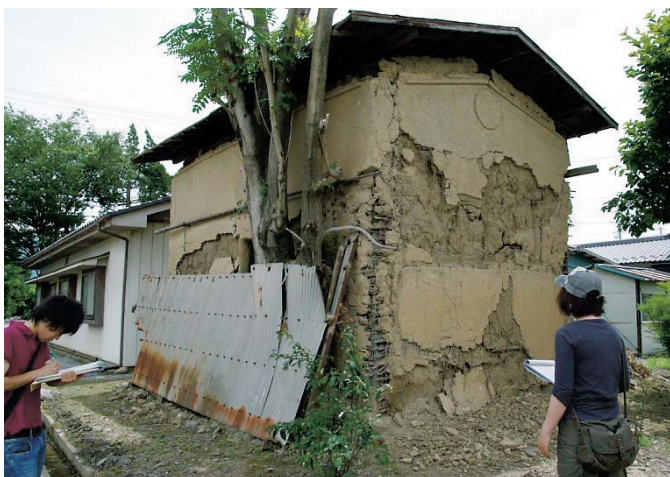
写真4 地震被害の調査（松本市）
